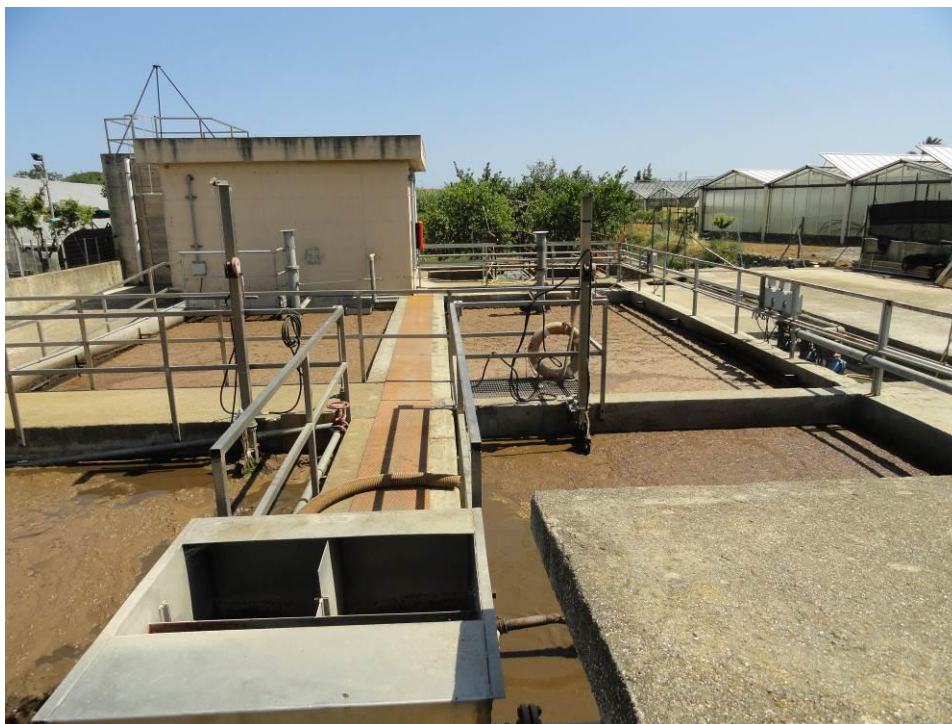
Figura 15 – impianto di depurazione esistente in comune di Albenga – loc. Campochiesa
